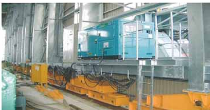
エンジン発電機 75kva
